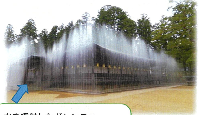
水を噴射したドレンチャー
